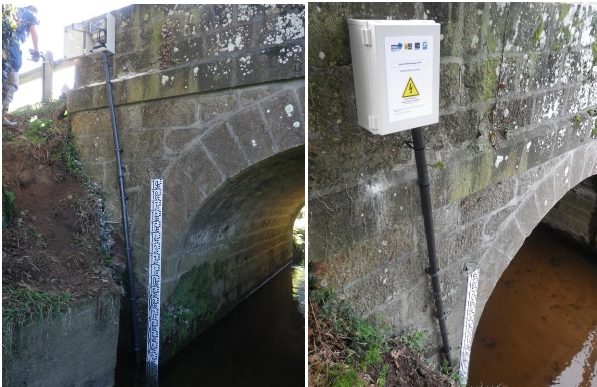
Figure 6 : Appareillages et échelle limnimétrique de la station hydrométrique du Ris ó EPAB 2013
