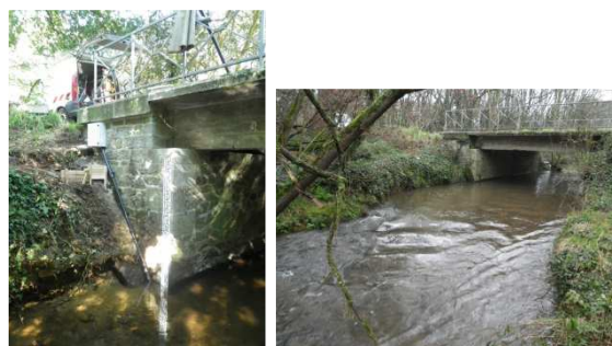
Figure 6 : Photographies de la station hydrométrique du Kerharo
